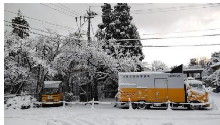
高圧発電機車による応急送電
