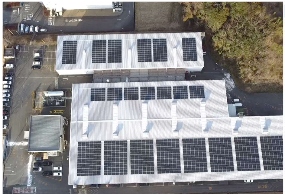
パルプモウルド茨城工場 太陽光発電パネル
