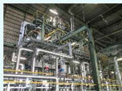
CO 2 原料のメタノール製造技術
