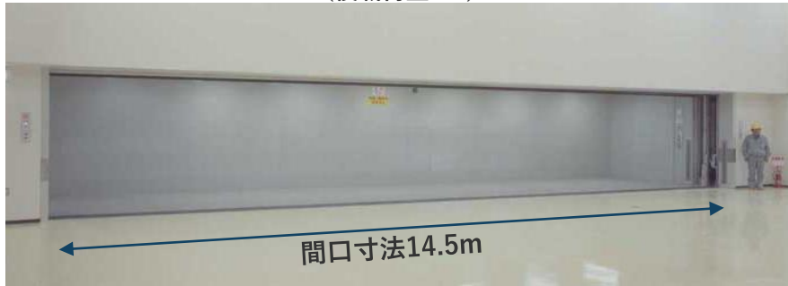
特殊荷物用エレベーター (積載荷重10t)
