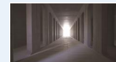
雨水貯留槽 M.V.P.システム
