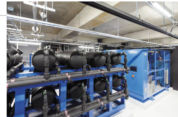
建物付帯型水素エネルギー利用システム 「Hydro Q-BiC」
