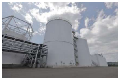
2023年5月 メタン発酵設備稼働
