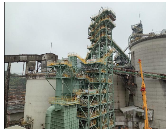
分級設備設置中の佐伯アッシュセンター（2024年6月完成予定）
