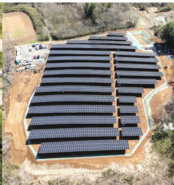
大田原市亀久太陽光発電所
