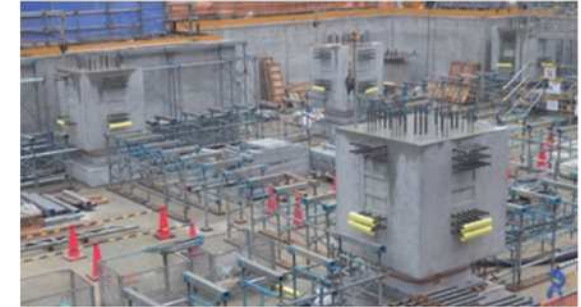
現在施工中の（仮称）福岡中央病院建替計画では多くのPCa部材を使用
