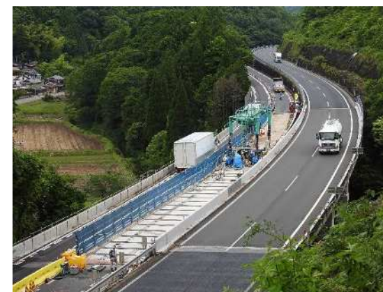
（中国自動車道）大谷橋床版取替工事 本工事では、当社独自工法の半断面床版取替工法、MuSSL工法が採用
