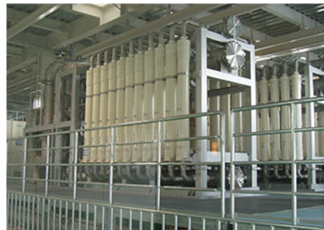
浄水施設(膜処理設備)の全景
