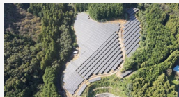
S-58 群馬高崎中里見 太陽光発電所
