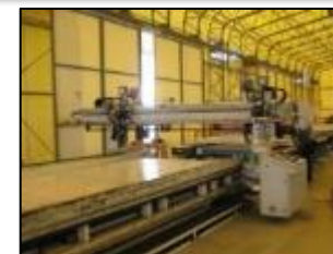
パネルシーシングライン (自動釘打ちマシン)
