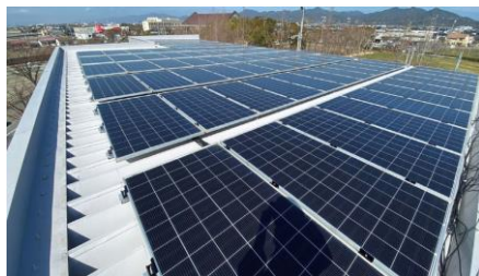
営農型太陽光発電所※1
