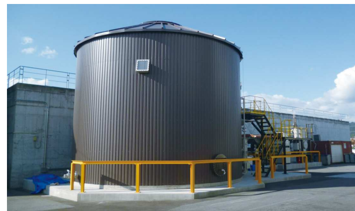
食品系バイオガスプラントの例
