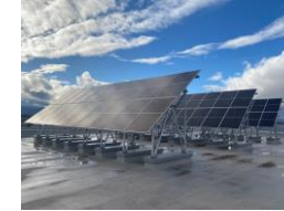
太陽光パネル
