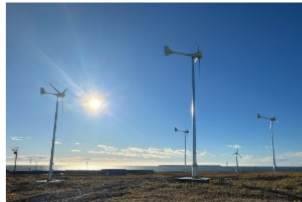
発電量5kw/基(北海道 花咲港)
