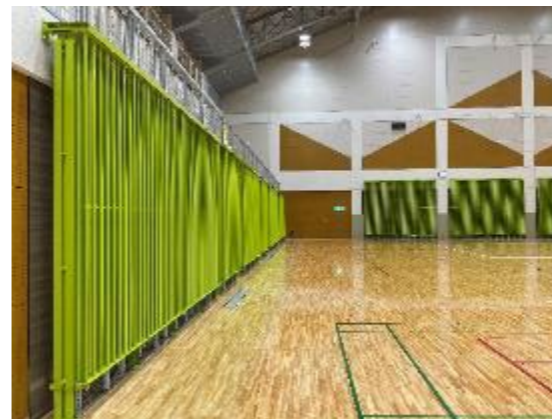
輻射冷暖房(体育館)
