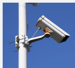
CCTVカメラ（監視）
