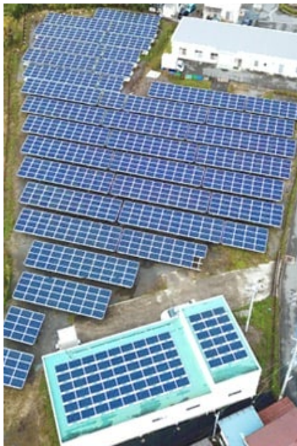
太陽光発電所
