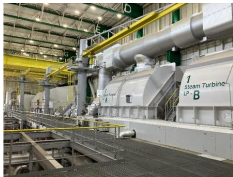
▲ タービン発電機
