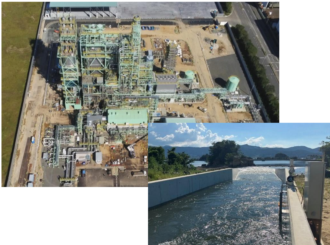
左：発電所全景（南側から北側を望む） 右：海水循環後の放水口
