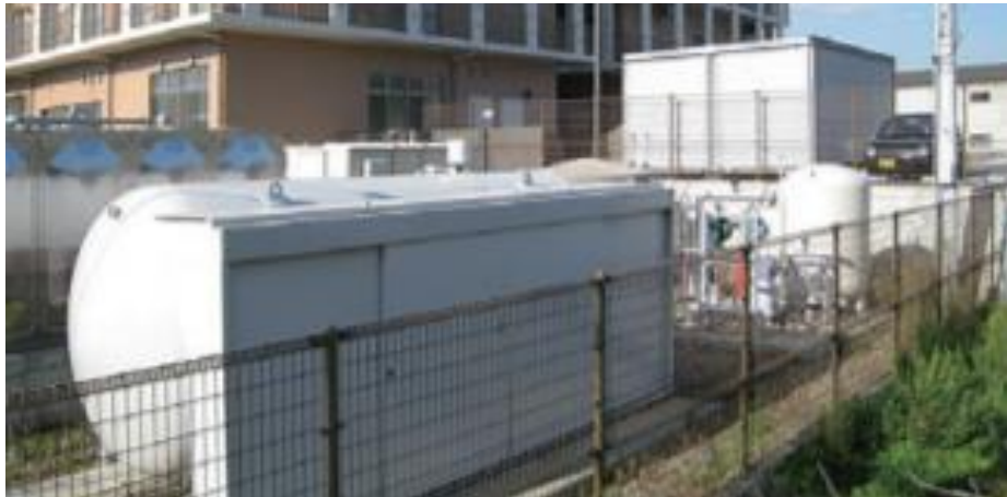
福祉施設（スプリンクラー設備）
