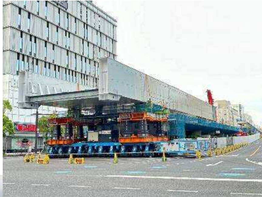
広島駅南口広場の再整備等における 駅部、駅前大橋上部工製作工事 株式会社大林組他JV
