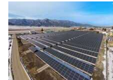
宮地エンジニアリング(株) 松本発電所
