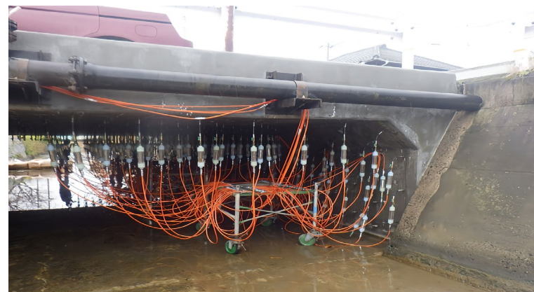
交通規制を伴わないK-LIP工法による床版補修への対応事例
