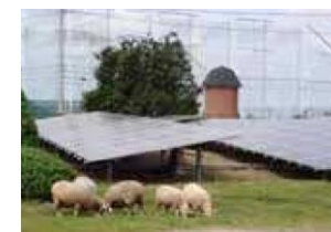
ソーラー売電施設（兵庫県）
