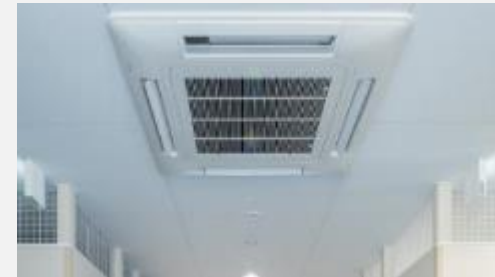
荷物に配慮した環境設備
