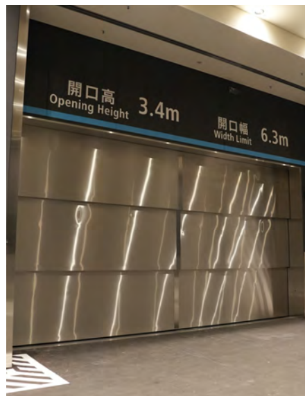
荷物用エレベーター
