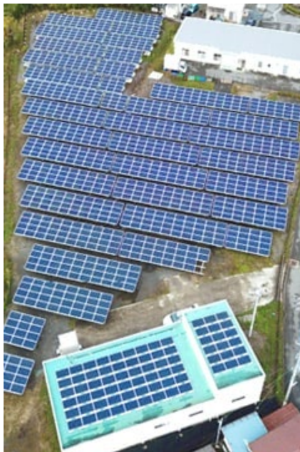
太陽光発電所
