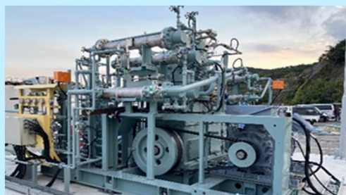
高圧水素圧縮機
