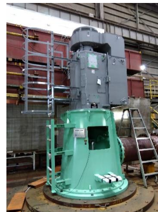
バイオマス発電用循環水ポンプ
