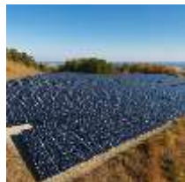
自社保有発電所 スマイル小平太陽光発電所（宮城県） 年間発電規模約2.4MW
