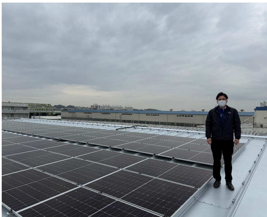
■ 屋上に設置された太陽光パネル
