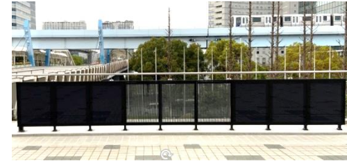
東京都「都有施設における再生可能エネルギー見える化モデル事業(建材一体型太陽光発電設備)」
